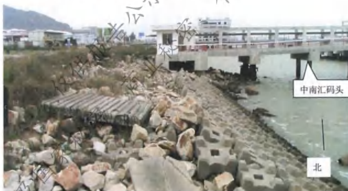
图 2.4.1-4 K0+671.8~K0+816.8 段破损区域情况
