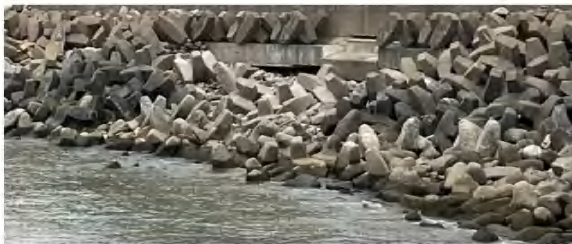
图 2.2.1-2 扭王字块体发生大面积滑移失稳现状照片
