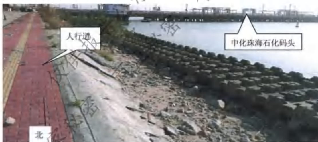
图 2.4.1-6 K1+009.5~K1+490.9 段破损区域情况
