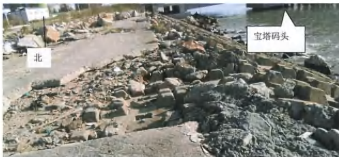
图 2.4.1-5 K0+816.8~K1+009.5 段破损区域情况
