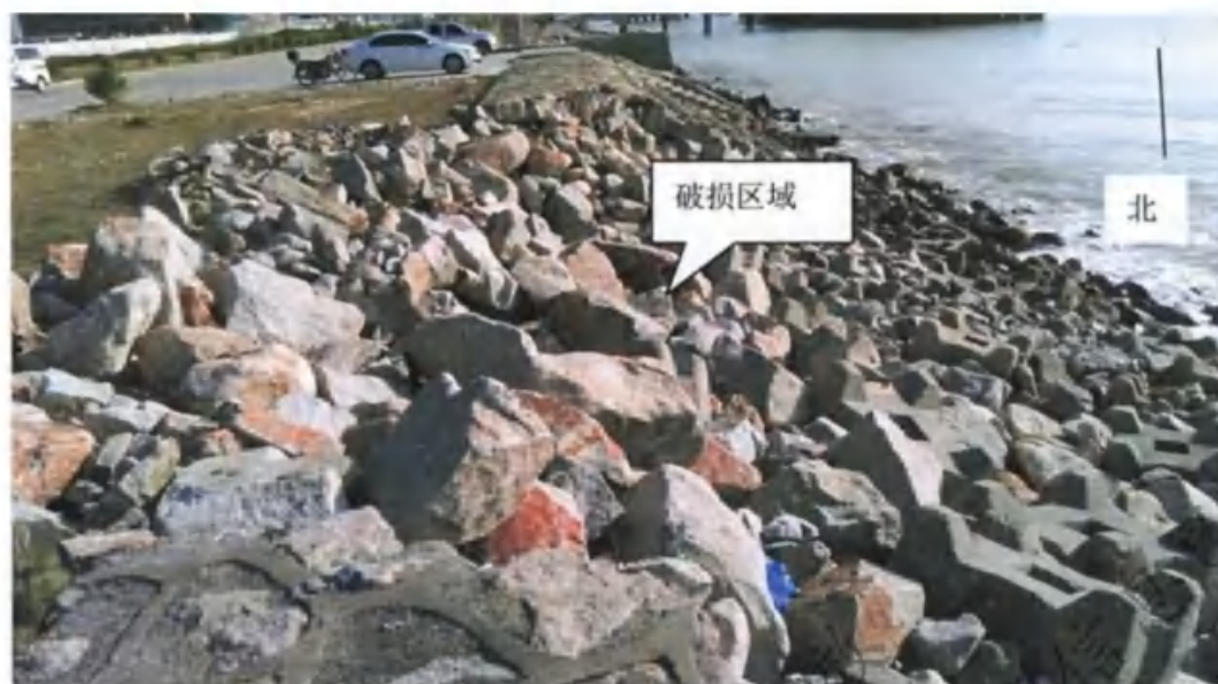
图 2.4.1-3 K0+250.7~K0+671.8 段破损区域情况
