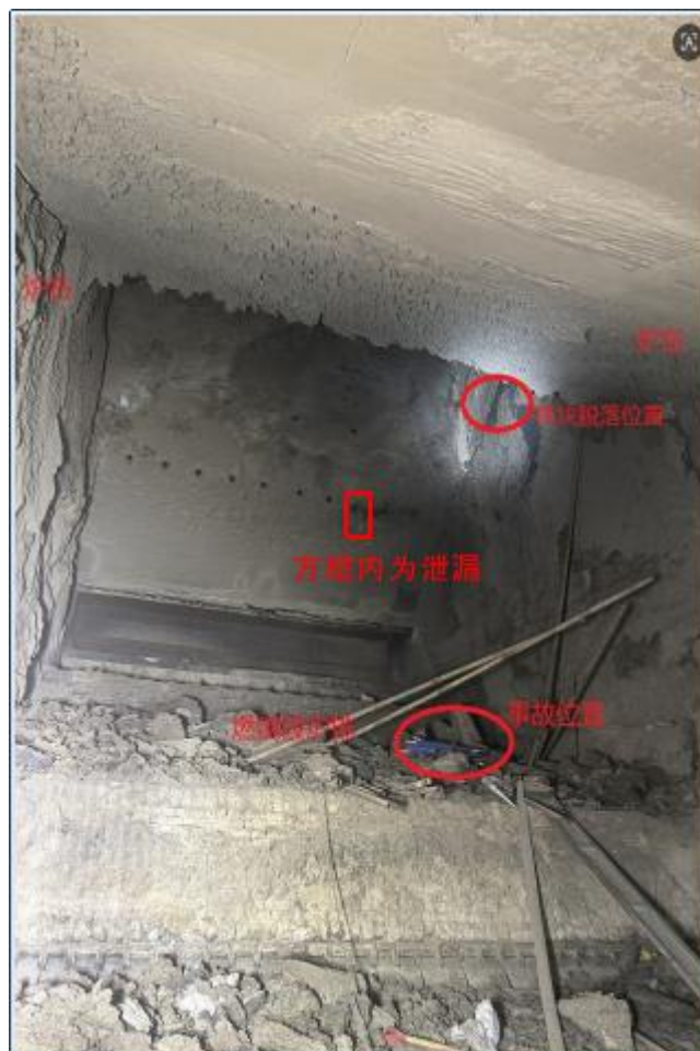
图 2 事故现场炉膛情况
