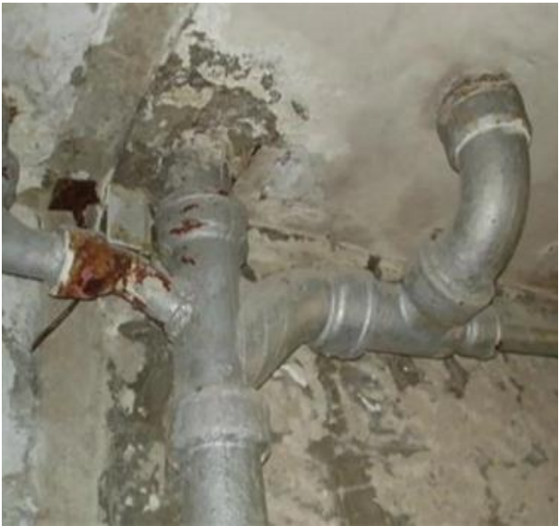
现状痛点：管网老化隐患
